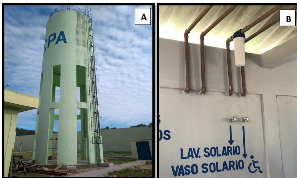
Figura 8 – Caixa D'água (A) e Filtro (B) acima de uma cela, Cadeia Pública de Altos, 2020 Fonte: registros da equipe durante o trabalho de campo.
